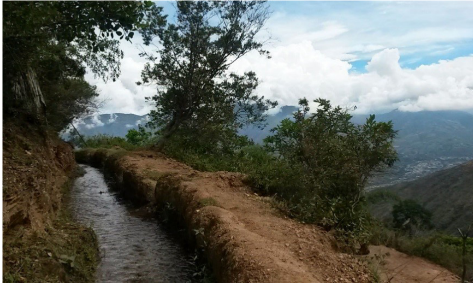
Imagen 4. Acequia de origen prehispánico, aldea El Platanal, Pueblos del Sur. Foto de Elimar Rojas Bencomo.
